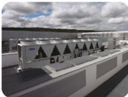
Data Centre di Orange, Normandia, Maggio 2022
