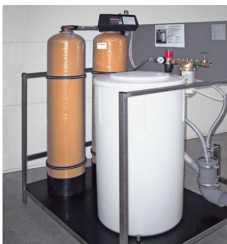
Impianto di addolcimento ad esercizio alternato
