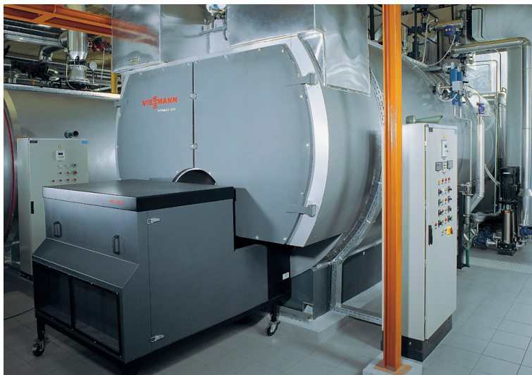
Generatore di vapore Vitomax RS con recuperatore del calore residuo e bruciatore
